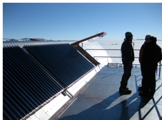
03_Antarktika_TUBO_Röhrenkollektor auf dem Dach.jpg
