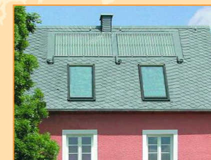
Kaum sichtbare indachmontierte TUBO-Module, Deutschland
